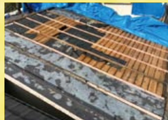
台風15号時の屋根の破損
